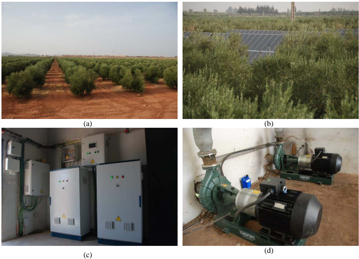
Fig. 4. Fotografías del sistema de riego FV instalado en Marrakech, Marruecos: (a) olivar, (b) parte del generador FV, (c) variadores de frecuencia y cuadros de control, (d) conjuntos motor-bomba.
