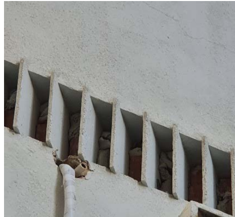
Fig. 9. Detalhe dos brises obstruídos pelos moradores Fonte: o autor.
