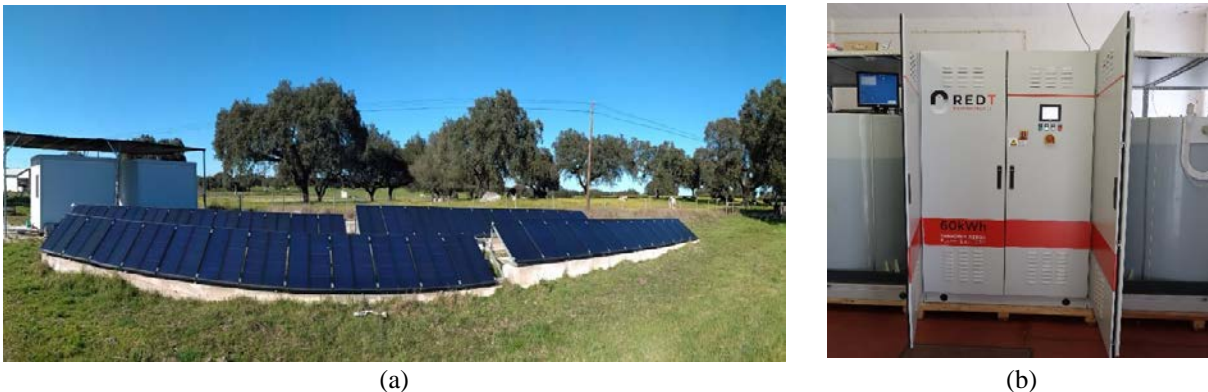
Figura 3: Sistemas de armazenamento de energia eléctrica: (a) sistema de 3,3 kW de PV (silício-amorfo); (b) bateria de fluxo Vanádio Redox com 60 kWh de capacidade.
