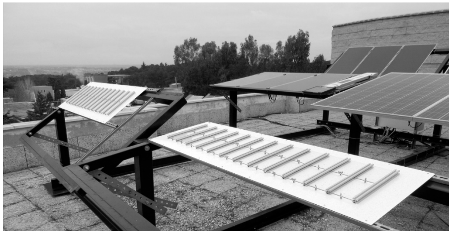
Fig 5. Vista general de la instalación FV experimental y del nuevo banco de pruebas de soiling .
