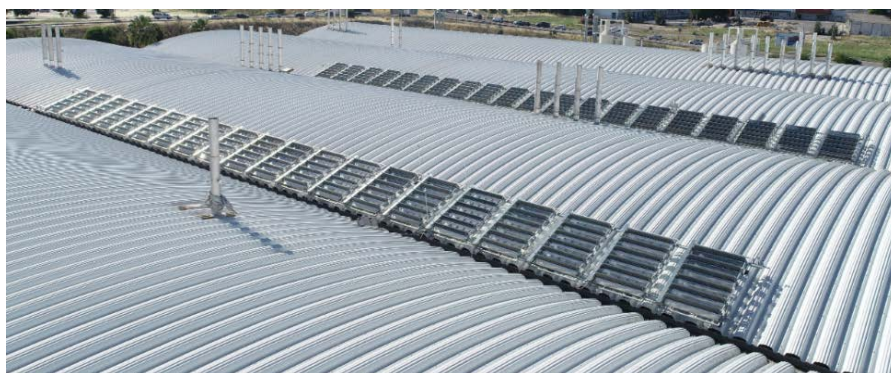
Fig. 7. Vista do campo solar instalado na cobertura.
