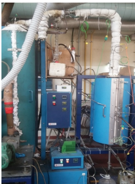
Fig. 1. Instalação de gasificação de biomassa e de limpeza e condicionamento do gás de gasificação.
