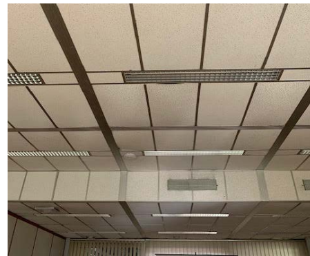
Fig. 5. Iluminação fluorescentes de primeira geração a ser substituída por LEDs.
