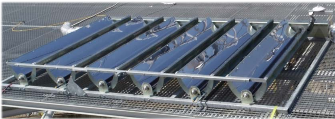
Fig. 4. Vista do módulo constituído por 6 vales em paralelo
