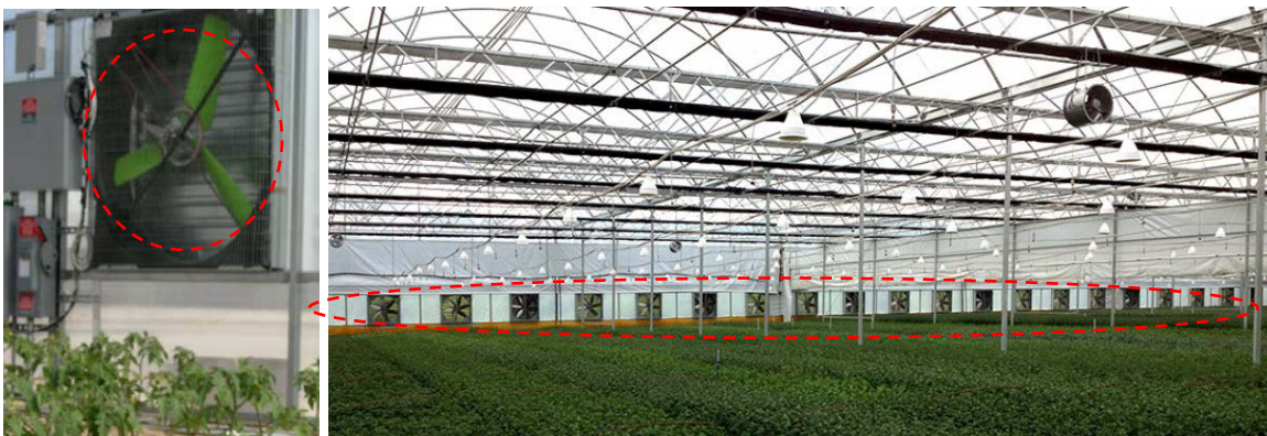
Fig. 1. Instalación de los extractores en los invernaderos ( http://www.novagric.com/es ).
